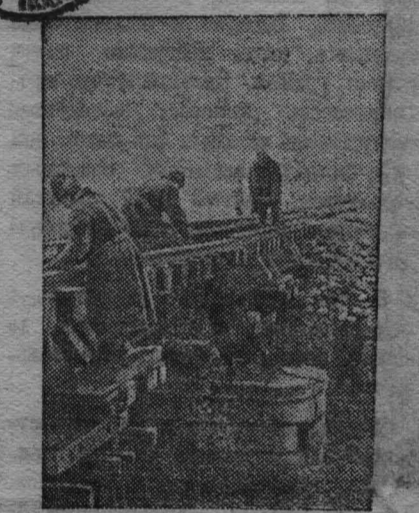
Бойцы железнодорожного восстановительного батальона за ремонтом взорванного противника моста. Фото Э. Евзеркина. (ТАСС)
