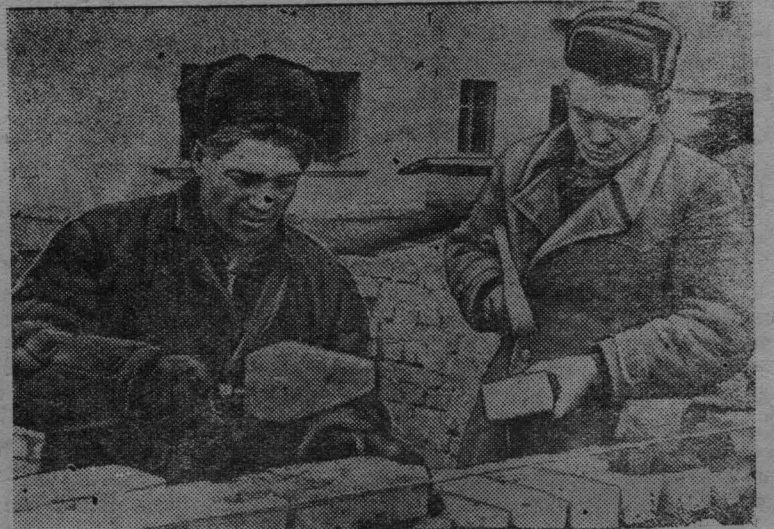
Строители 5-го участка Ленинского стройуправления треста «Лениншахтострой» ведут большой объем работ по сооружению жилья для горняков шахты «Егозовская-1/2». Хорошо трудится здесь бригада каменщиков, которой руководит Петр Иванович Гоменко. На кладке стен жилых домов коллектив перевыполняет задание на 50—70 процентов.
