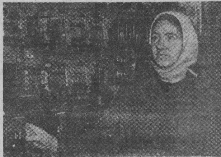
Сложная современная аппаратура установлена на главном вентиляторе шахты «Полысаевская-1». Хорошо несет службу на своем рабочем месте дежурная Марфа Степановна Рафикова, которую вы видите на снимке за проверкой работы полуавтоматики. Фото В. Володина.
