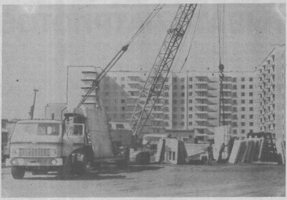
Несмотря на сложности с финансированием, строительство жилья в городе идет - за счет АО «Ленинскуголь», других предприятий, имеющих возможность расплачиваться со строителями. В канун шахтерского праздника планируется завершить строительные работы на одном из жилых домов.
