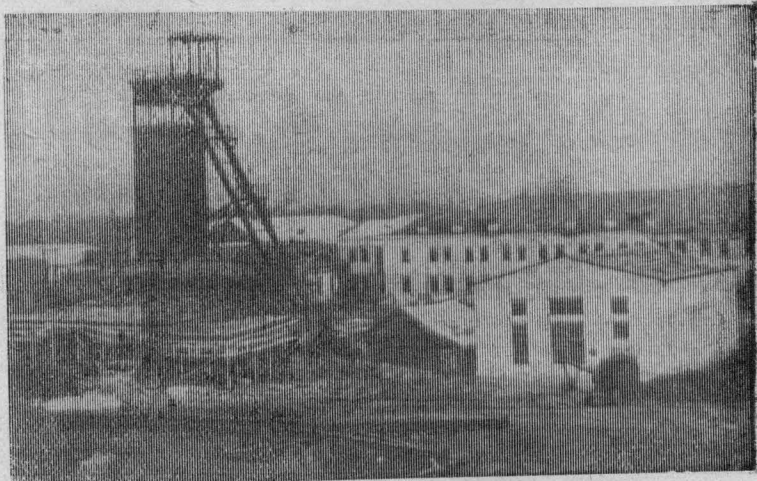
Коллектив пятого участка Польсаевского шахтостроительного управления ведет реконструкцию шахты «Комсомолец». Большой объем работ здесь выполняется по скиповому и клетевому стволам, надшахтным зданиям. После реконструкции производственная мощность шахты значительно возрастет.
